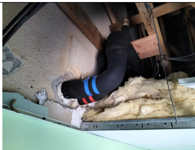
Passage du réseau de chauffage par les combles
