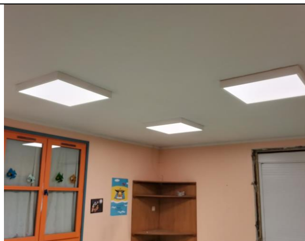
Cassettes à leds posées en plafond pour les salles sans faux-plafond
