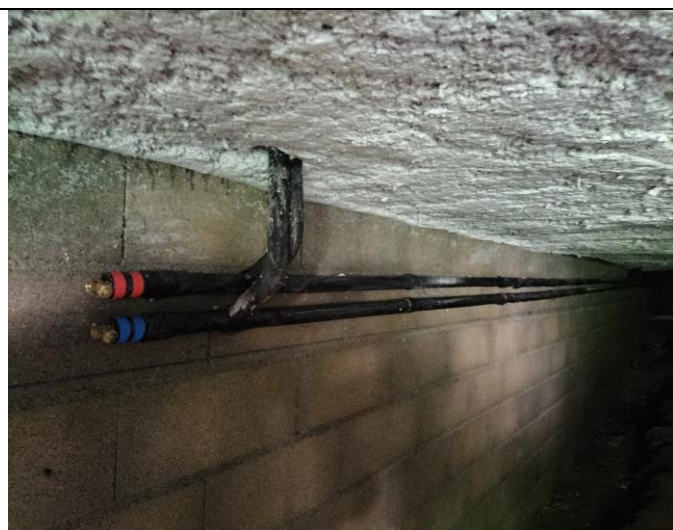
Passage du réseau de chauffage central et isolation par flocage des sous-sols dans la partie la plus récente de l'école
