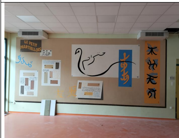
Batteries de chauffage de la salle de psychomotricité
