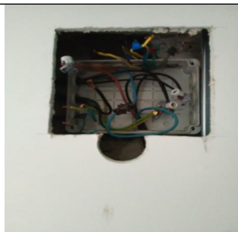
Découverte de vices cachés de l'installation électrique (exemple d'une boîte électrique cachée derrière un doublage)
