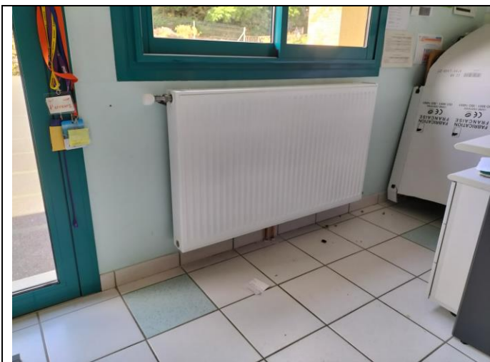
Radiateurs du circuit de chauffage central dans les salles de classe
